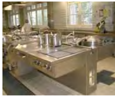
写真7 壁掛け式厨房機器
