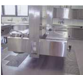
写真6 天井吊型加熱機器
