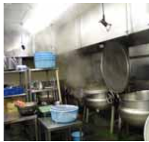
写真1 国内厨房実例
