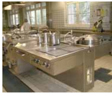
写真7 壁掛け式厨房機器
